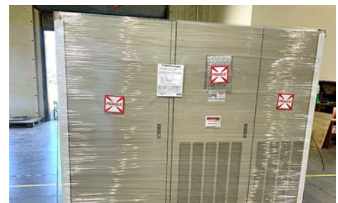
Mitsubishi 500 kVA UPS
