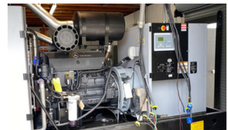
MTU 200kW DS200
